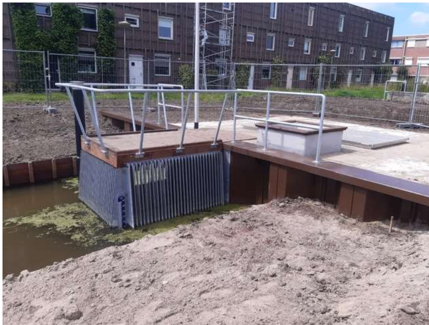
Gemaal De Westbroek
