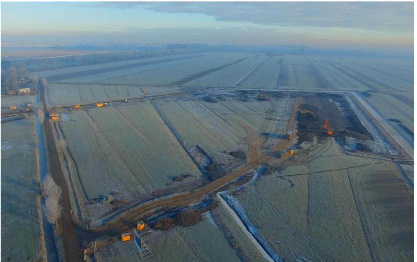
Overzichtsfoto van de toekomstige waterberging met de Achterdijk (links), het veendepot (rechts), de stuw met vispassage (midden achter) en op de achtergrond Schalkwijk.
